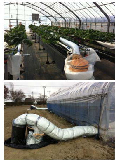
図2. 条間配風ダクト(上図) および地下通風ダクト(下図)
